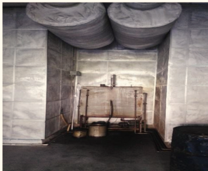
图5 油机房油箱的安全隐患示意
