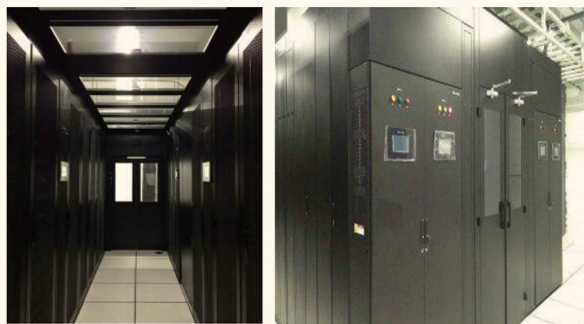
图6 无锡电信模块化DC舱应用场景
