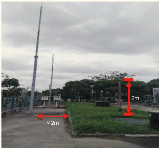
图2 避雷针距离油库储油罐小于2m
