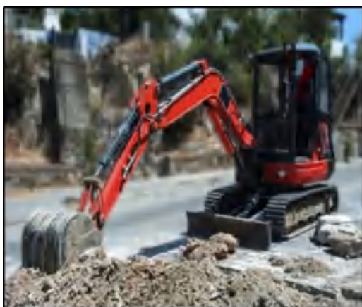
光缆被外力破坏
